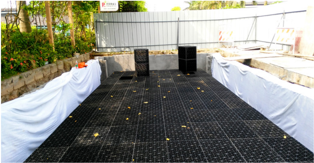
Rainwater management system 雨水管理系統
