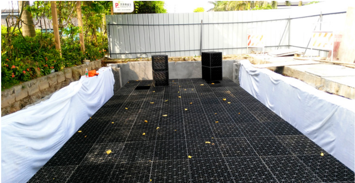
Rainwater management system 雨水管理系統
